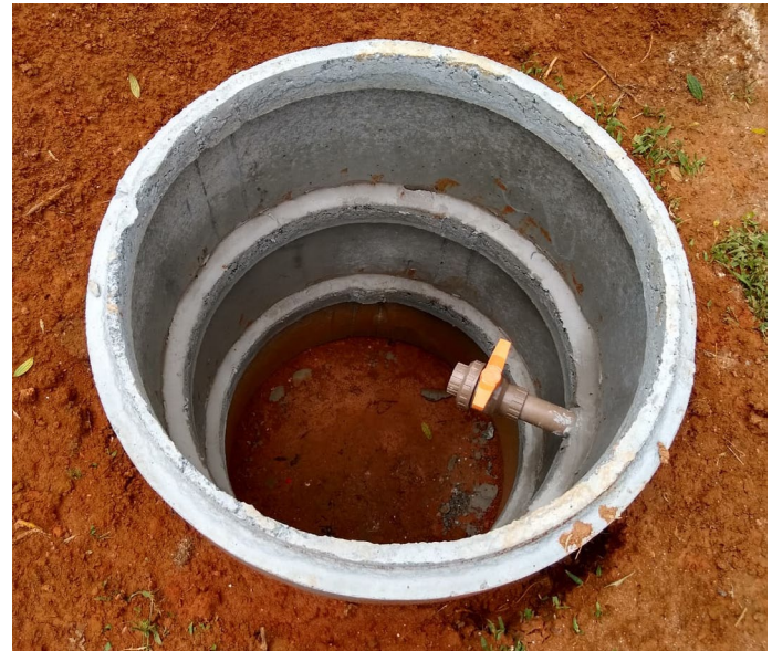
Caixa de Lodo com o registro instalado. Verava, Ibiúna/SP. Foto: Paola Samora.
