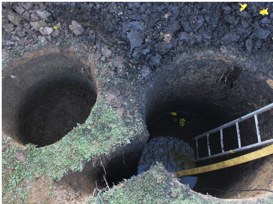
Escavação pronta para a descida dos anéis de concreto. Verava, Ibiúna/SP. Foto: Paola Samora.
