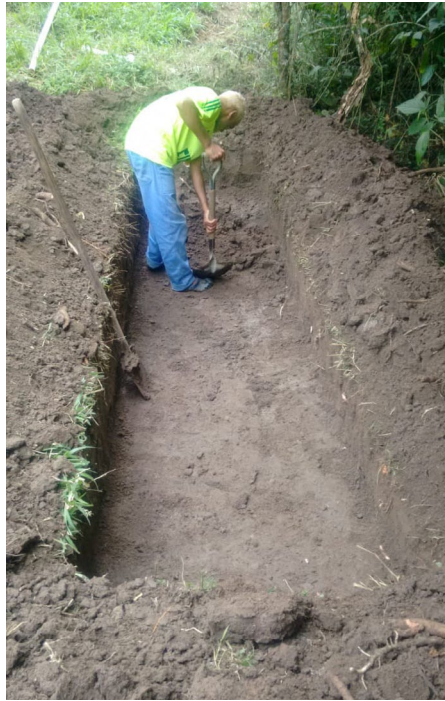
Escavação da vala de infiltração (à esq.), e escavação concluída (à dir.). Verava, Ibiúna/SP. Foto: Rosemiro P. Oliveira.
