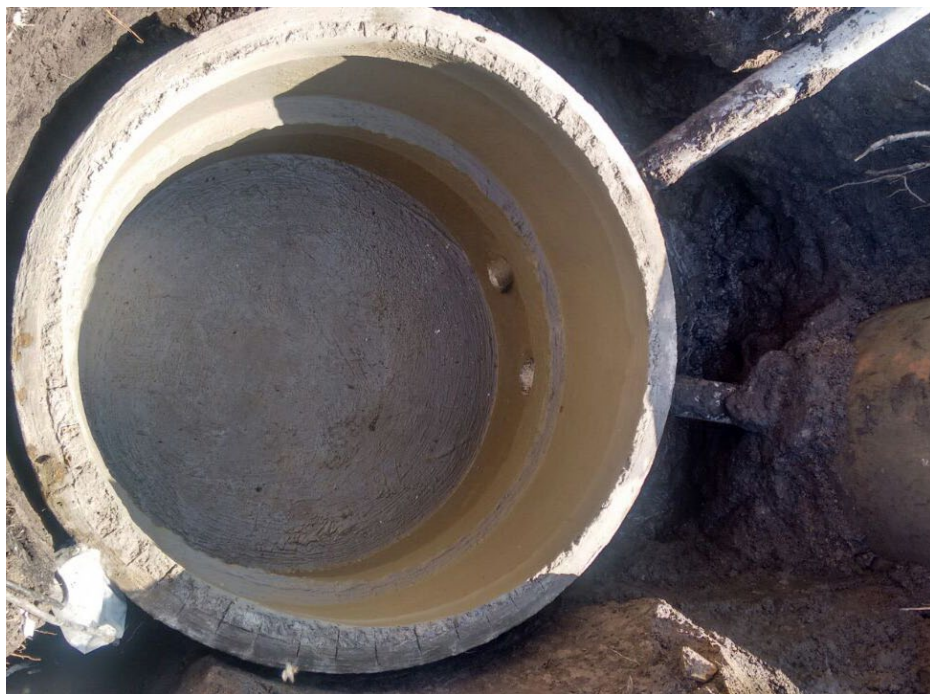
Chegada e saída das tubulações no biodigestor. Verava, Ibiúna/SP. Foto: Paola Samora.
