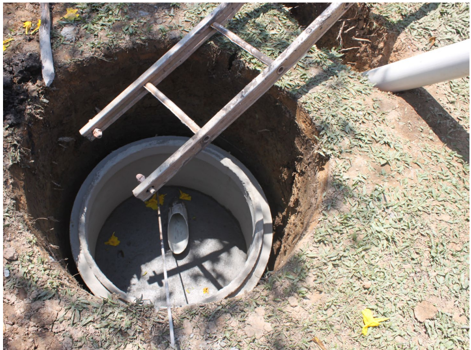
Chegada da tubulação do biodigestor na base da caixa de compensação. Verava, Ibiúna/SP. Foto: Paola Samora.
