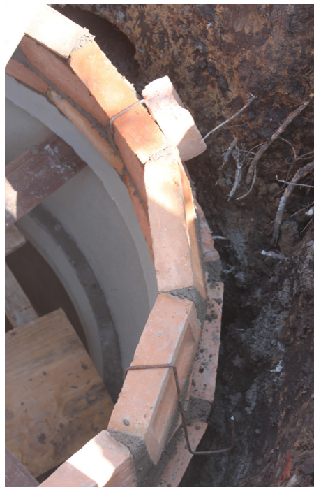
Guia para assentamento dos tijolos da cúpula (à esq.), e detalhe do contrapeso para assentamento dos tijolos da cúpula (à dir.). Verava, Ibiúna/SP. Foto: Paola Samora.
