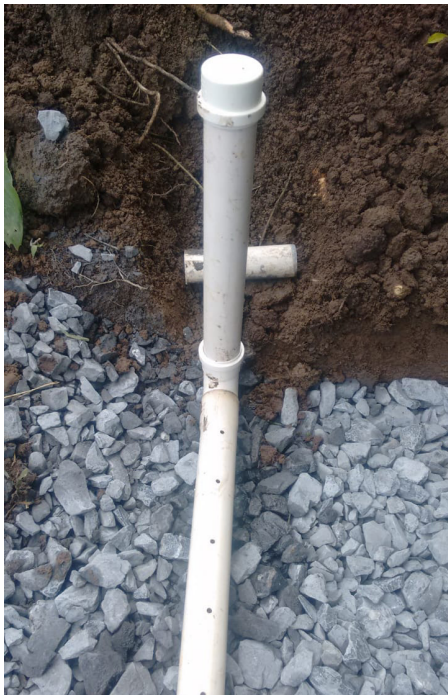
Detalhe do tubo de ventilação. Verava, Ibiúna/SP. Foto: Rosemiro P. Oliveira.
