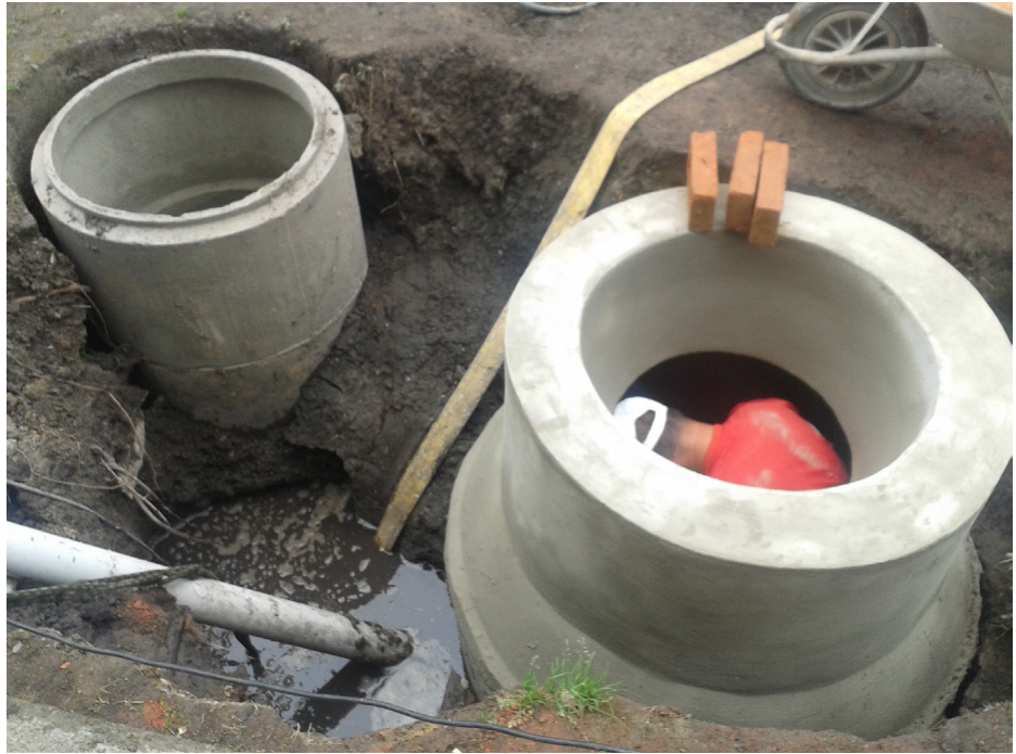
Vista da passagem da tubulação de chegada no biodigestor. Verava, Ibiúna/SP. Foto: Paola Samora.
